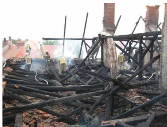
Požar krovišta A.Cesarca 4
