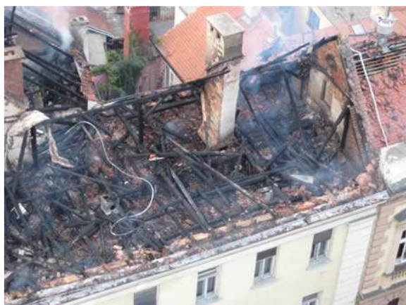
Požar krovišta A.Cesarca 4
