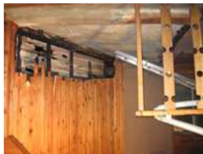
Požar kuće Goljaci
