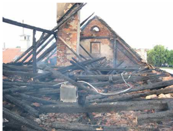
Požar krovišta A.Cesarca 4
