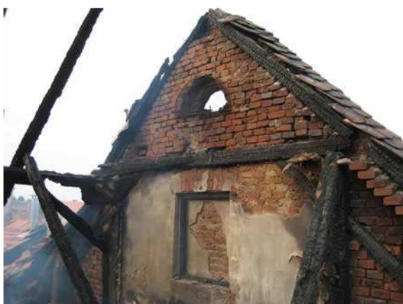
Požar krovišta A.Cesarca 4
