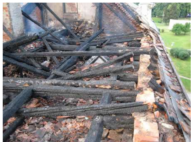
Požar krovišta A.Cesarca 4
