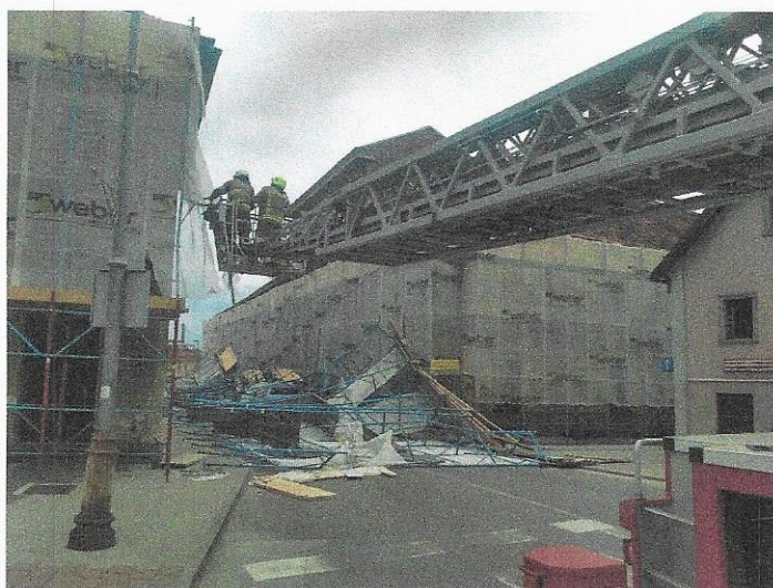
Slika: Sanacija urušavanja građevinske skele zbog jakog vjetra
